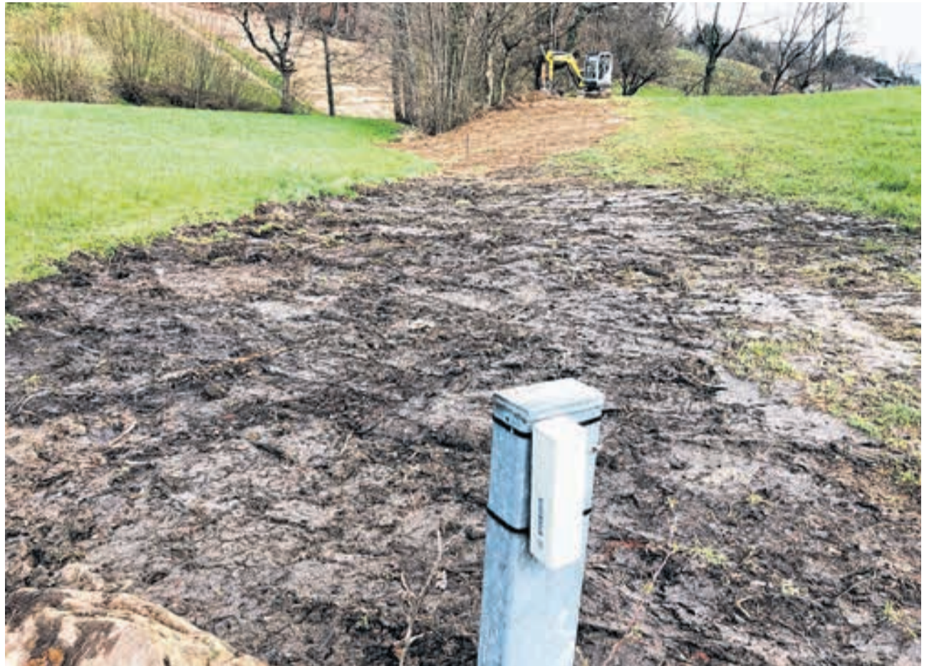
Beim Krebsbach sei ohne Bewilligung gerodet und eingedolt worden, moniert das Bürgerforum Freienbach. Das nachträglich eingereichte Baugesuch sei voller Fehler, weshalb man mit einer umfassenden Einsprache dagegen vorgehe.
